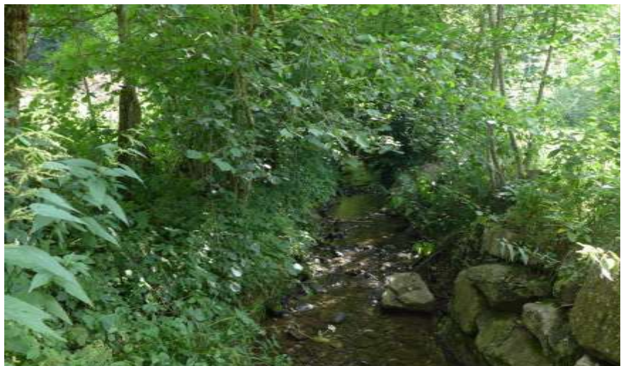
Abbildung 32: Teilweise sind die Verbauungen am Rickenbach in schlechtem Zustand (Foto 126).
