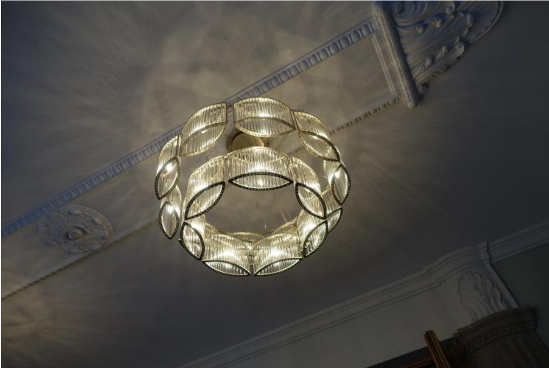
Neue Deckenleuchte im ausgebauten Stadttheater. Bild: Manuel Pestalozzi
