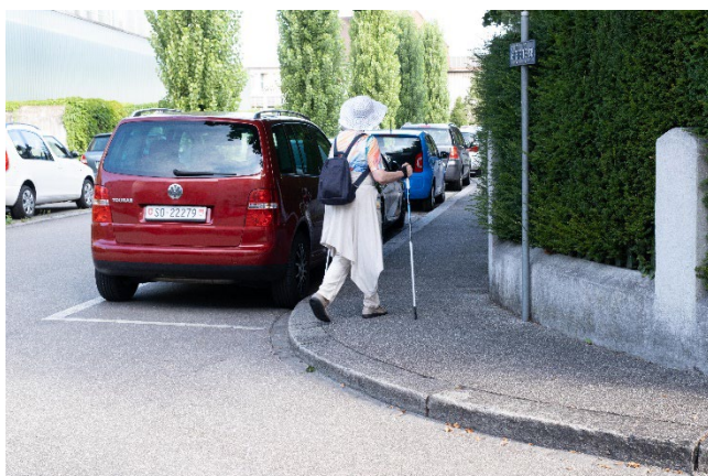
Abbildung 37: Nicht BehiG-konformer Randabschluss (eigene Aufnahme)
